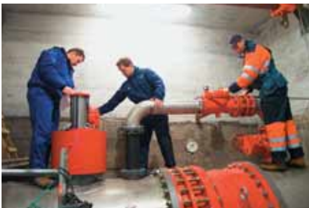
Úr lokuhúsi og pípa Þverárvirkjunnar.
