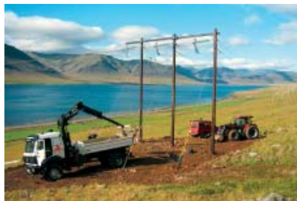
Nýtt horn í 66 kV línu, Dýrafirði.
