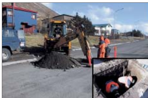
Bilun heimtaug á 2m dýpi, Seljalandsvegi Ísafirði.
