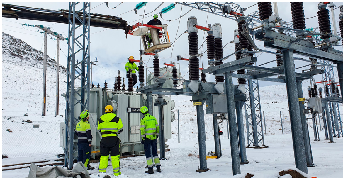
Aðveitustöð á Keldeyri í Tálknafirði.
